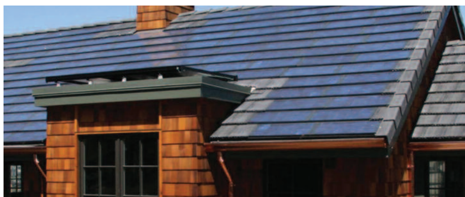
BIPV på tak. Foto: Applied Solar.
